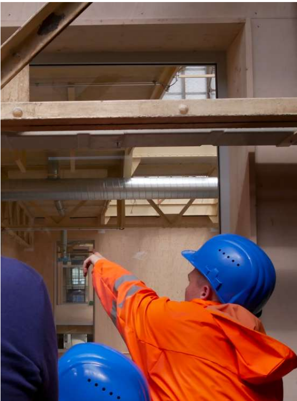
Da sich kein Mieter/Mieterin für die gesamte große Werkshalle finden ließ, wird diese in Teilabschnitte unterteilt. Zugeständnis an den Denkmalschutz: Fensteröffnungen durchziehen alle Unterabschnitte. Mietvertraglich wird abbedungen, dass diese Indoor-Fenster nicht zugestellt oder abgeklebt werden dürfen, damit die Durchschau erhalten bleibt und sich die ursprüngliche Dimension der Halle erahnen lässt.
