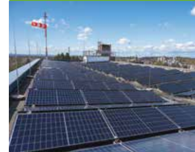
Die große Photovoltaik-Anlage auf dem Dach des EVK Bergisch Gladbach | Foto: Daniel Beer
